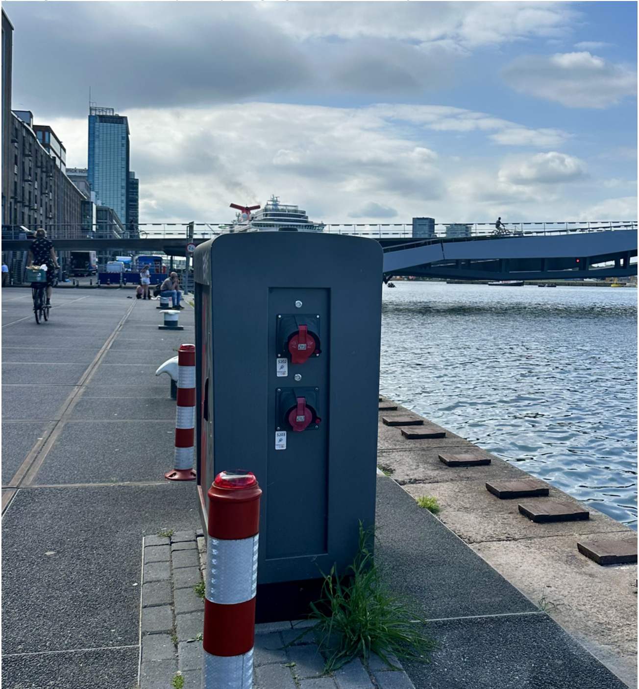
Een walstroomaansluiting voor afgemeerde binnenvaartschepen
